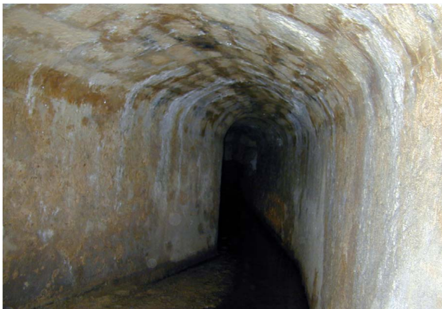
► Fig. 4 : ancien aqueduc de Marly (dénommé ensuite : aqueduc du Levant), 1669-1670 (cl. Br.B.)
